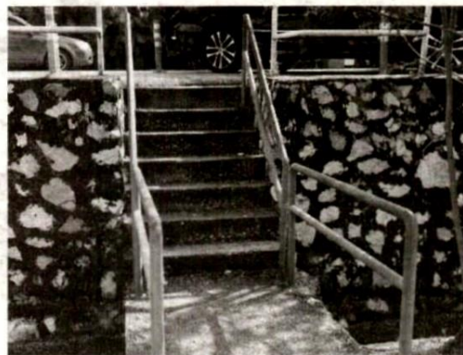
KEADAAN selusur tangga di Jalan Liku A 8/A, Shah Alam yang sudah uzur. - IHSAN PEMBACA
